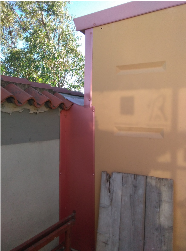
Scossaline e soluzioni di raccordo fra il muro perimetrale e il colombario
